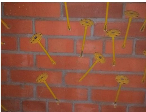
а) Посторонние предметы в кирпичной кладке
