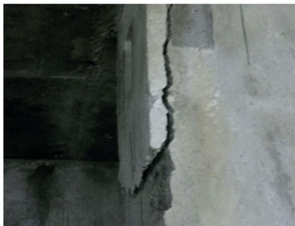
в) скол в вентиляционном блоке
