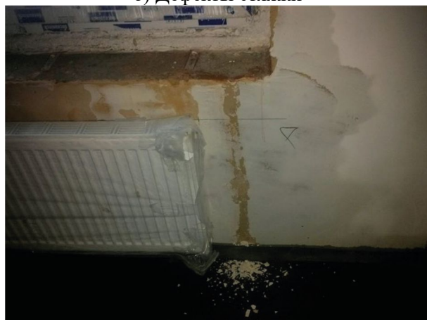
г) отслоение шпаклевки, намокание поверхности.
