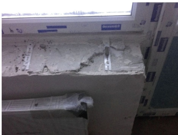
б) Дефекты стяжки
